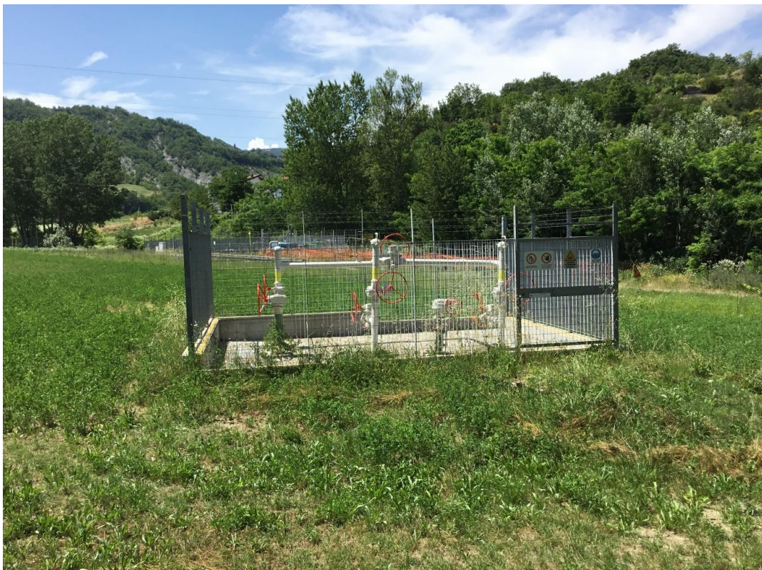
Fig. 3: vista fotografica dell'impianto PIDI oggetto di intervento
